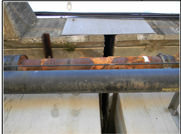
내 용 S7 배수관 고정부 파손
