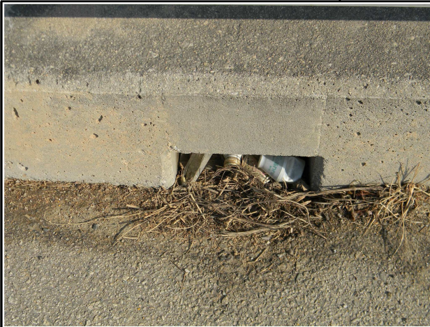
내 용 S1 교량상부 배수구 막힘
