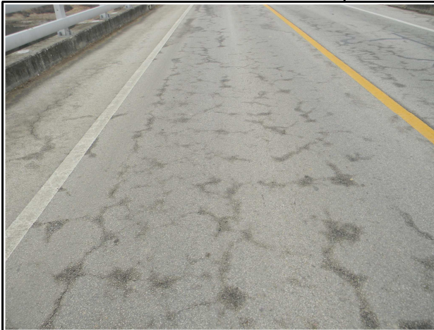
내 용 S10 교면포장 아스콘 망상균열
