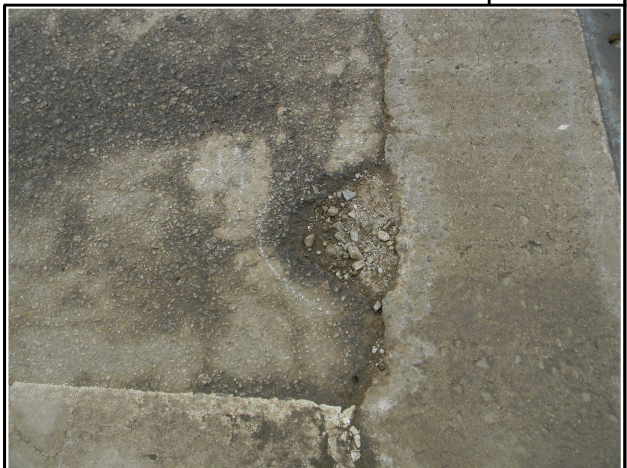
내 용 S19 교면포장 아스콘 파손
