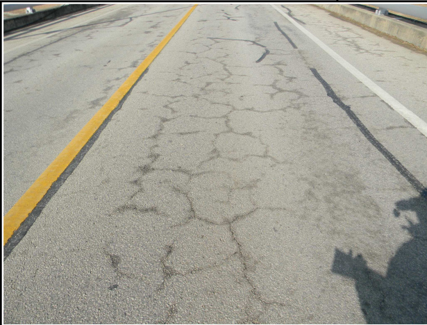
내 용 S2 교면포장 아스콘 망상균열
