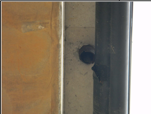
내 용 S8 배수관 탈락
