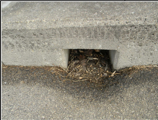
내 용 S6 교량상부 배수구 막힘
