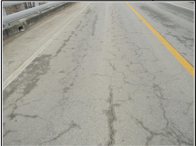
내 용 S15 교면포장 아스콘 망상균열
