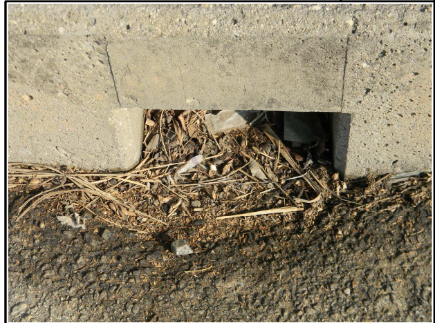
내 용 S2 교량상부 배수구 막힘
