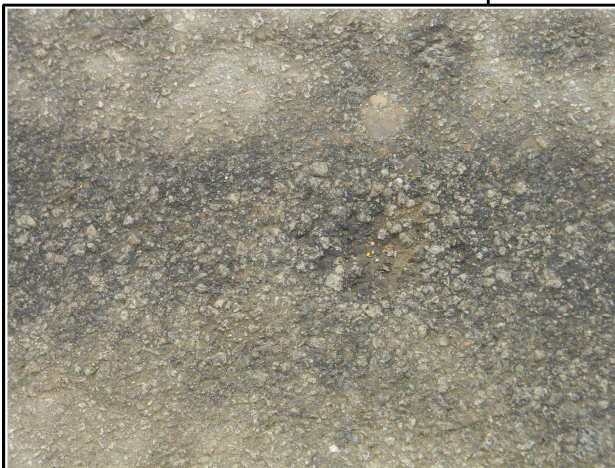
내 용 S18 교면포장 아스콘 패임
