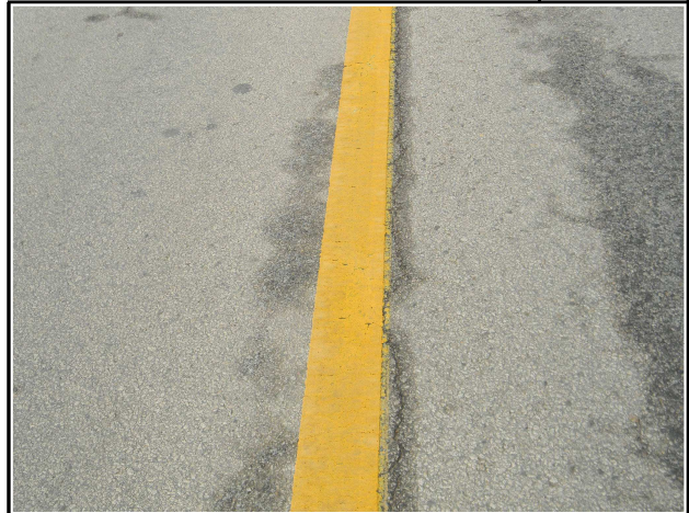
내 용 S5 교면포장 아스콘 균열
